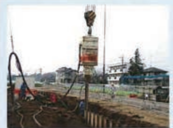
矢板規格：SP-Ⅲ型 (L=10.5m) 発注：国土交通省 工事名：日野共同溝工事
