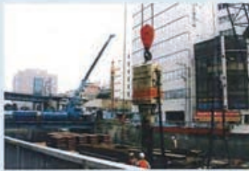
杭規格：H350×350 (L=16m) 発注：東京都 工事名：目黒川大崎橋架替工事
