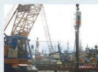
矢板規格：SP-Ⅲ型 (L=16m) 発注：JR東日本 工事名：柳原構内新設工事
