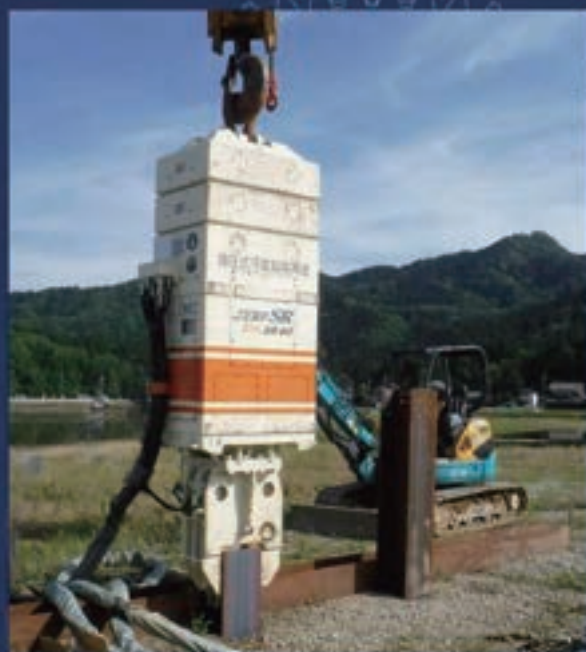
工事名: 北陸新幹線福井橋りょう他 杭規格: 350H(L=23.0m) 施工現場: 福井県福井市
