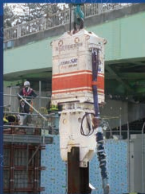
工事名: 和歌山下津港海岸(海南地区) 等の浦水門取付護岸築造等工事 杭規格: 350H(L=36.5m) 発注: 国土交通省
